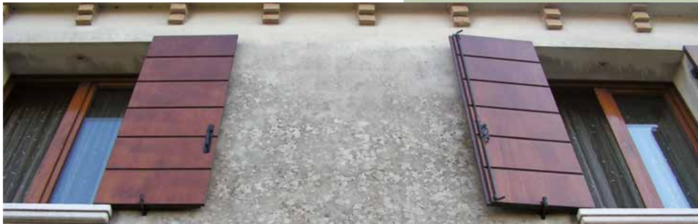
FACCIATE MARCATE DALLA COLORAZIONE DI ALGHE E MUFFE • ALGAE AND MOULDS ON FACADES
