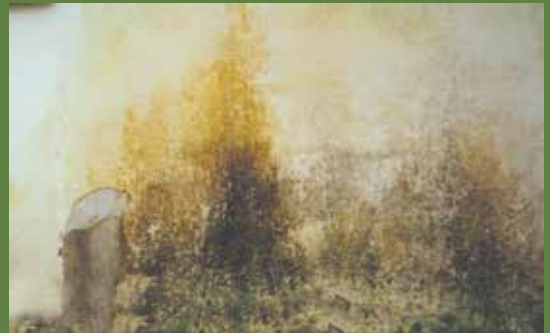
ESEMPI DI DETERIORAMENTO
